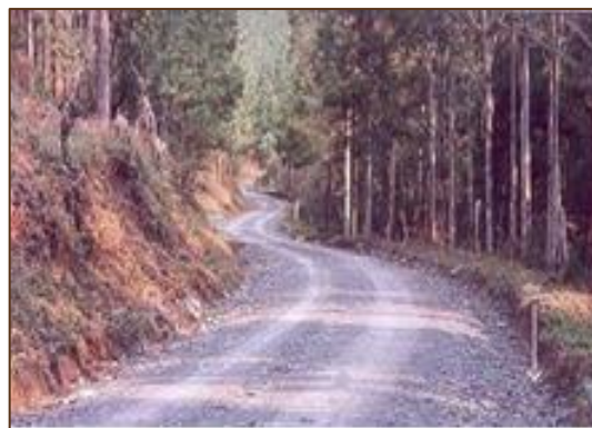
Imagem 12: Valeta lateral em local de longo declive.
